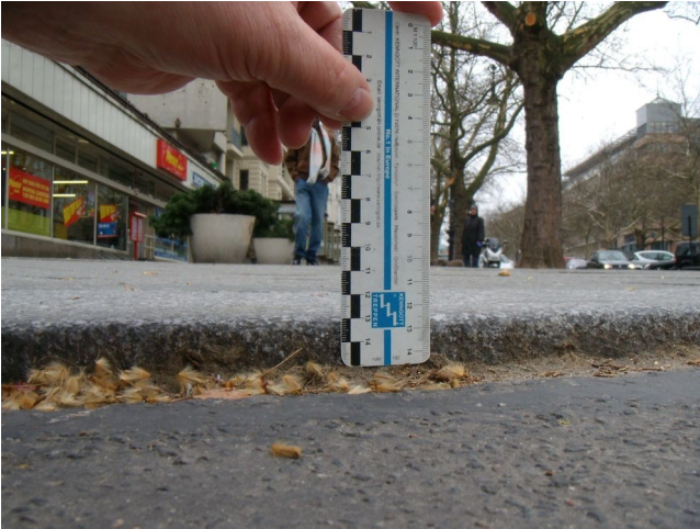
Bild 1: Bordsteinabsekkung am Ku'damm: Das sollen 3 cm sein ? Ich sehe hier etwas mehr als die Hälfte.
