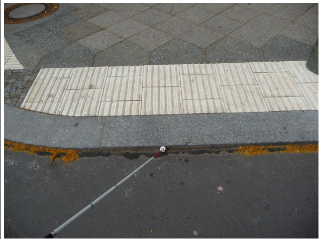
Bild 4: Berlin, Grazer Damm, fotografiert vom Fahrdamm her. Die Kante des Bordsteins zum Belag der Fahrbahn ist exakt 3 cm hoch. Man sieht und fühlt: Es geht doch, wenn man nur will ! Verlegt wurden hier auch korrekt die neuen Rippenplatten der AV Geh- und Radwege, Anlage 13, mit dem Langstock wesentlich besser zu ertasten als die alten Rillenplatten mit viel zu engen Profilaabständen.
